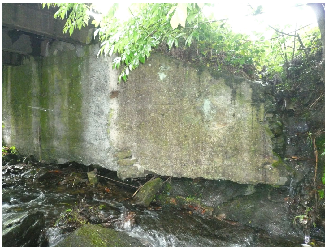
Fot. 5. podmyty przyczółek lewy od strony dolnej wody.
