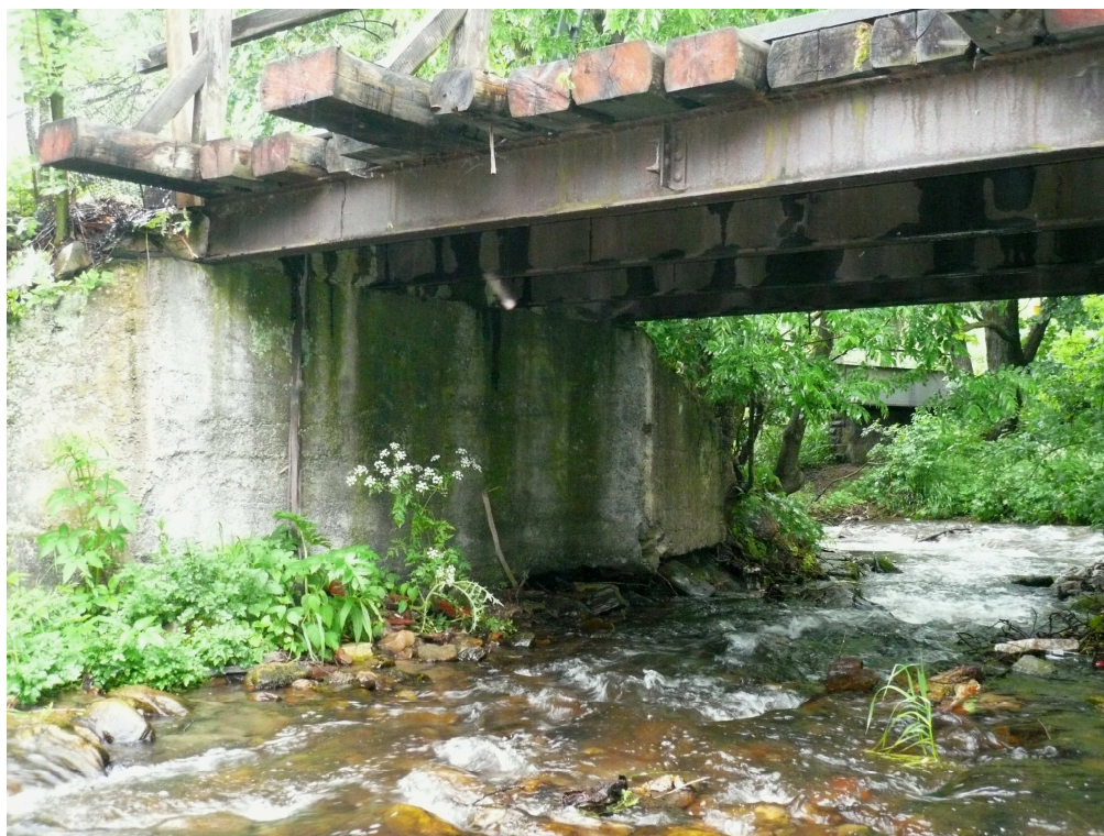
Fot. 4. widok spodu mostu i podmytych przyczółków od strony górnej wody.
