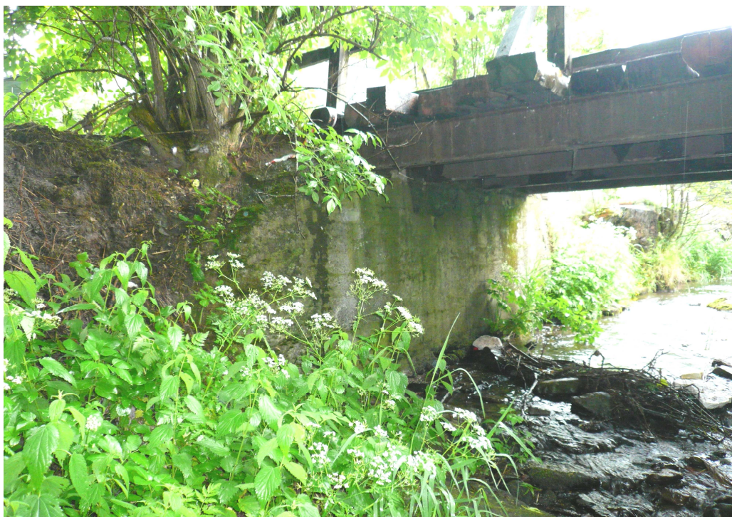
Fot. 6. podmyty przyczółek prawy od strony dolnej wody.
